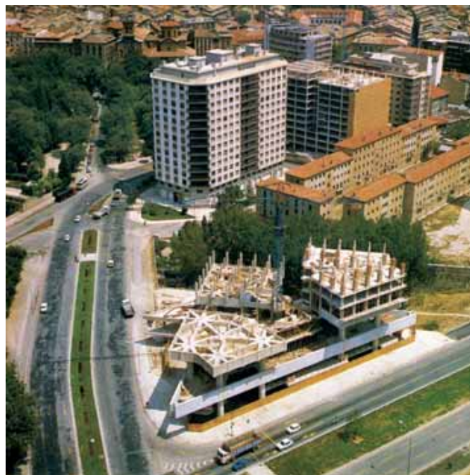
Estado de las obras de construcción del Edificio Singular. 19 de julio de 1973 (Foto Paisajes Españoles).
